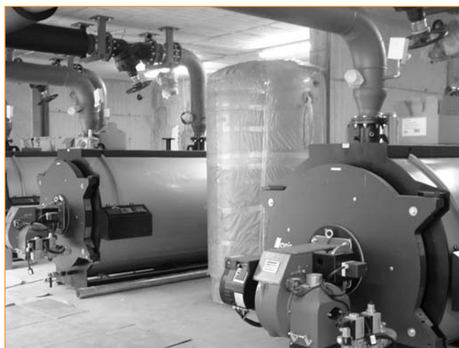
Maquinària del nou centre d'instal·lacions energètiques
