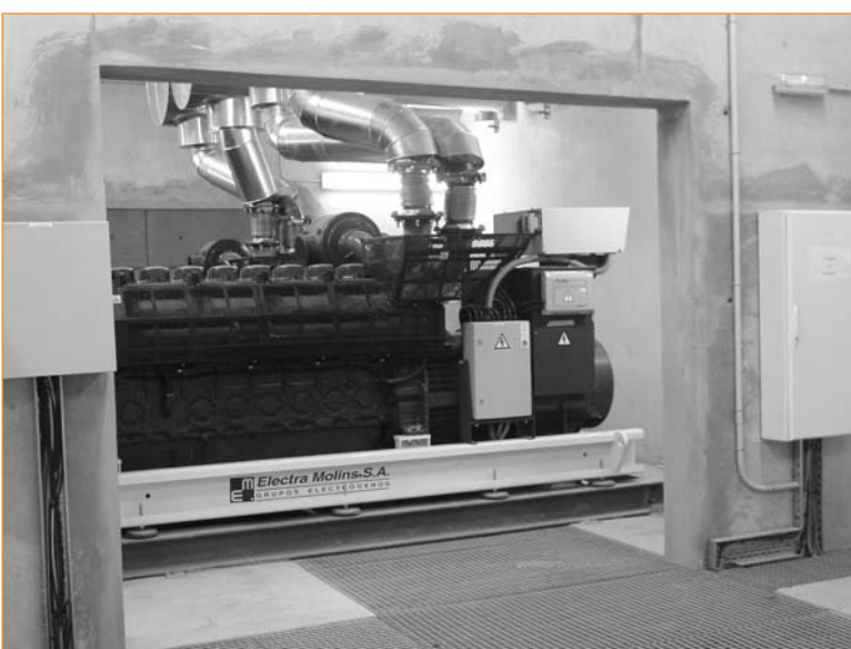
Maquinària del nou centre d'instal·lacions energètiques
