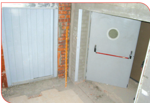
Ascensor i porta per comunicar les plantes de l'edifici B
