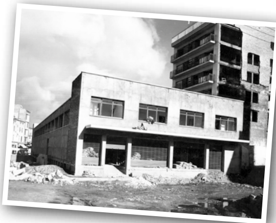
CONSTRUCCIÓ DEL MERCAT DE SANT CARLES, 1967 FOTOGRAFIA D'AUTOR DESCONEGUT / COL·LECCIÓ AJUNTAMENT DE GRANOLLERS / AMGR
