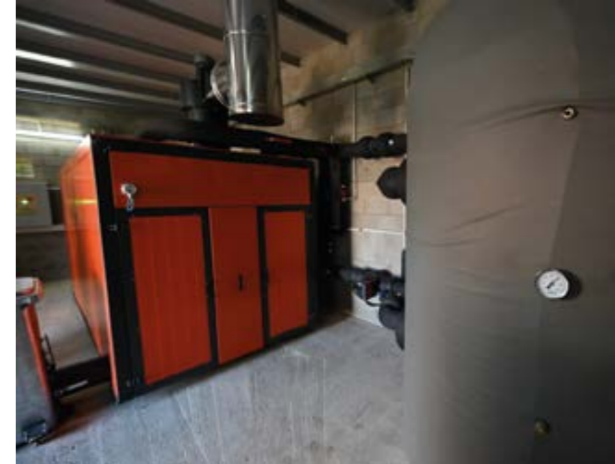
Caldera i acumulador de la Xarxa Nord
