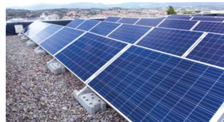
Plaques solars fotovoltaïques al Centre Vallès
