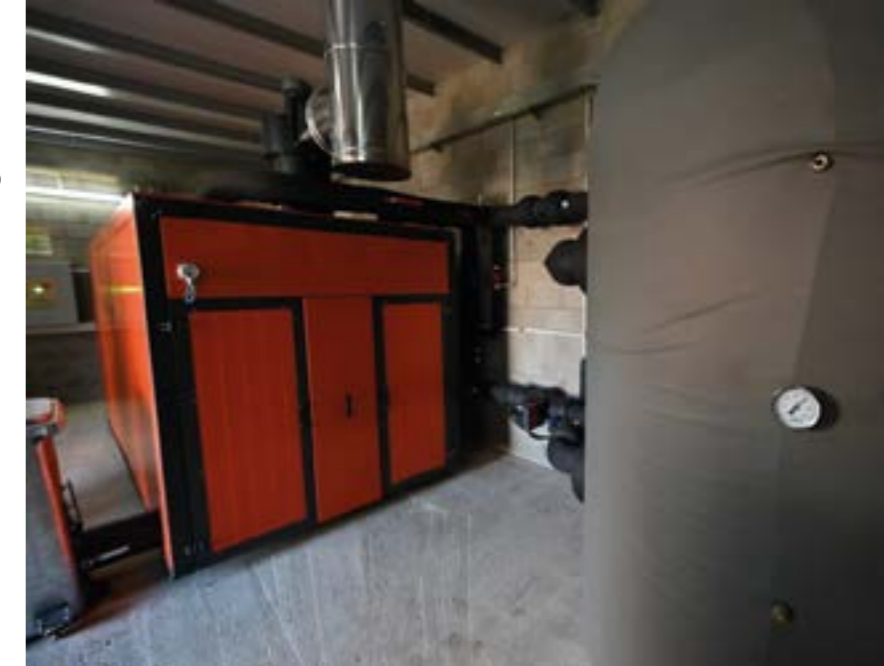
Caldera i acumulador de la Xarxa Nord
