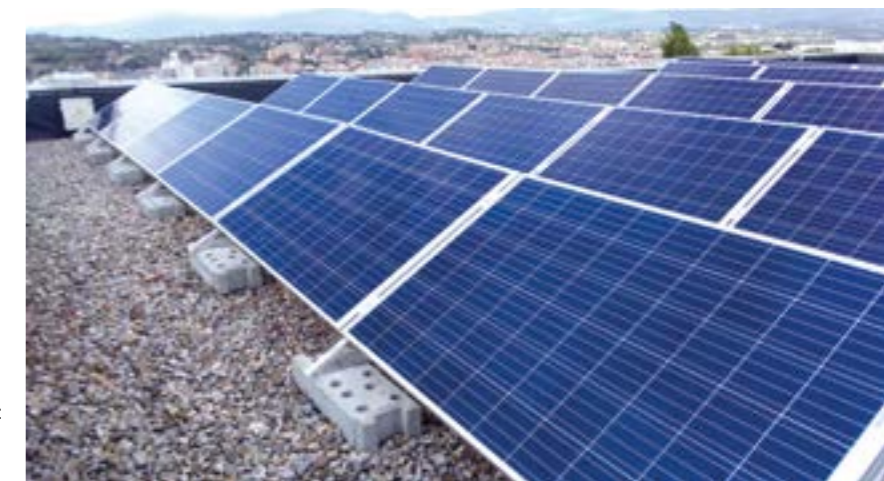
Plaques solars fotovoltaïques al Centre Vallès
