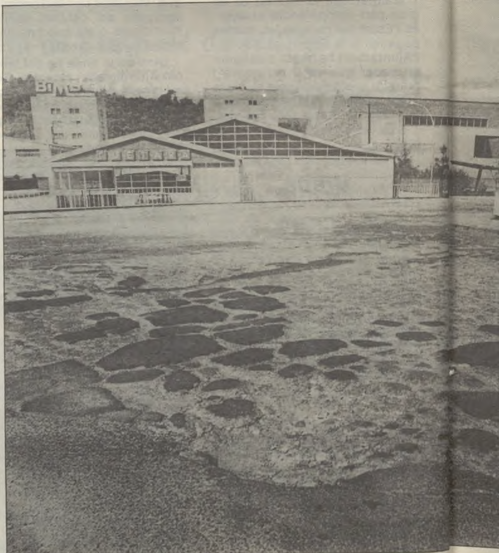
Hay calles con más baches que asfalto.
