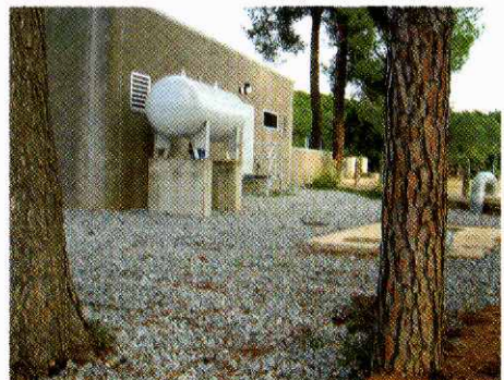
Noves instal·lacions per l'abastament d'aigua potable.
