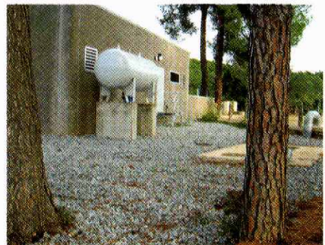
Noves instal·lacions per l'abastament d'aigua potable.
