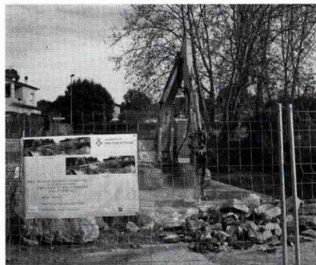
El qual de Sant Isidre sobre el Tenes és on han començat les obres del pla d'adequació de tota la llera del riu al seu pas per Santa Eulàlia.
