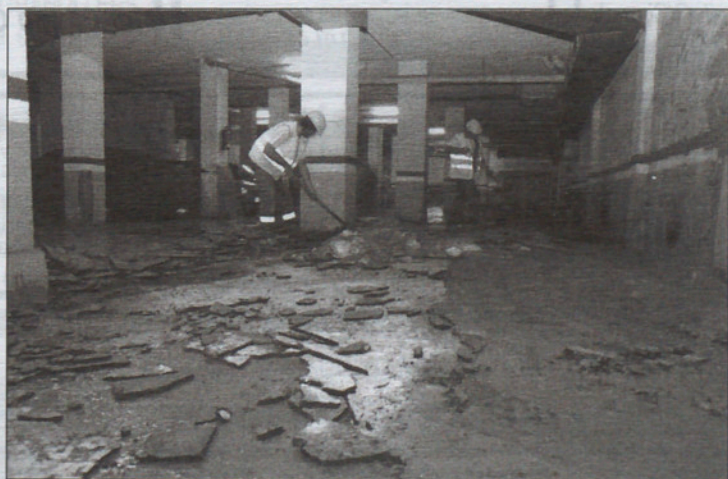
Parking del sótano donde se produjo la inundación una vez achicada el agua.
