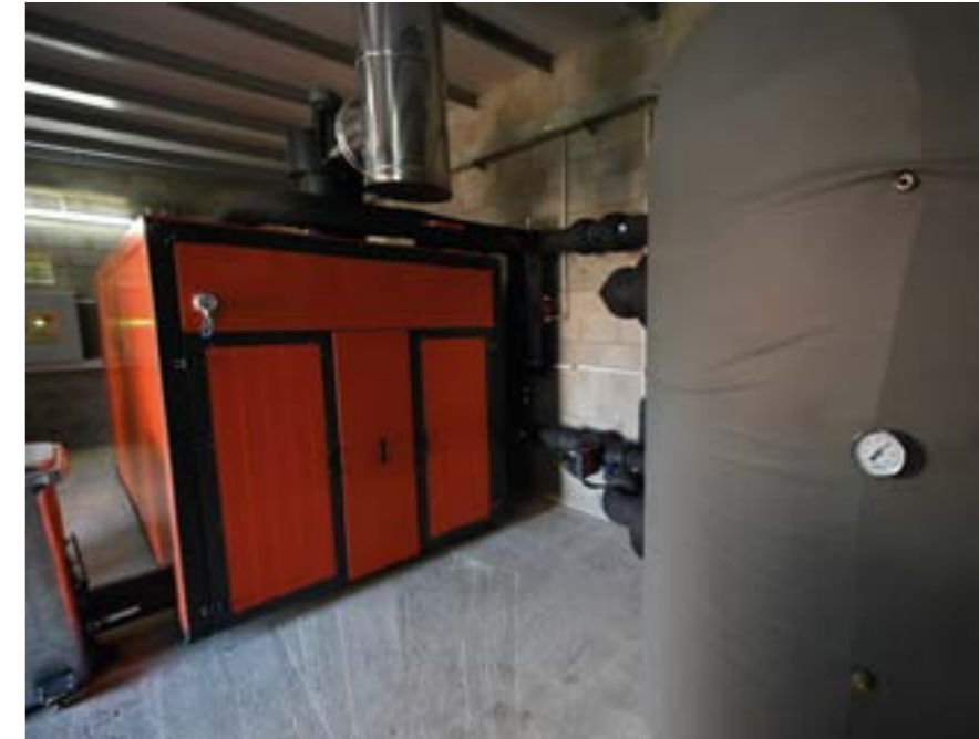
Caldera i acumulador de la Xarxa Nord
