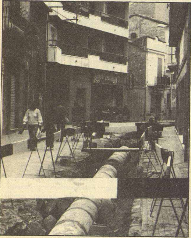
El pasado 13 de octubre se iniciaron las obras de construcción de la segunda fase de la zona peatonal del centro comercial de Mollet del Vallès.
