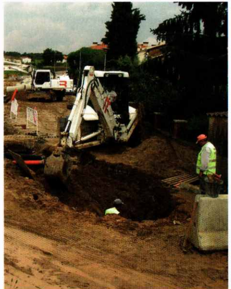
Les obres d'urbanització i millora no han parat durant tot l'any en diferents indrets del poble.
