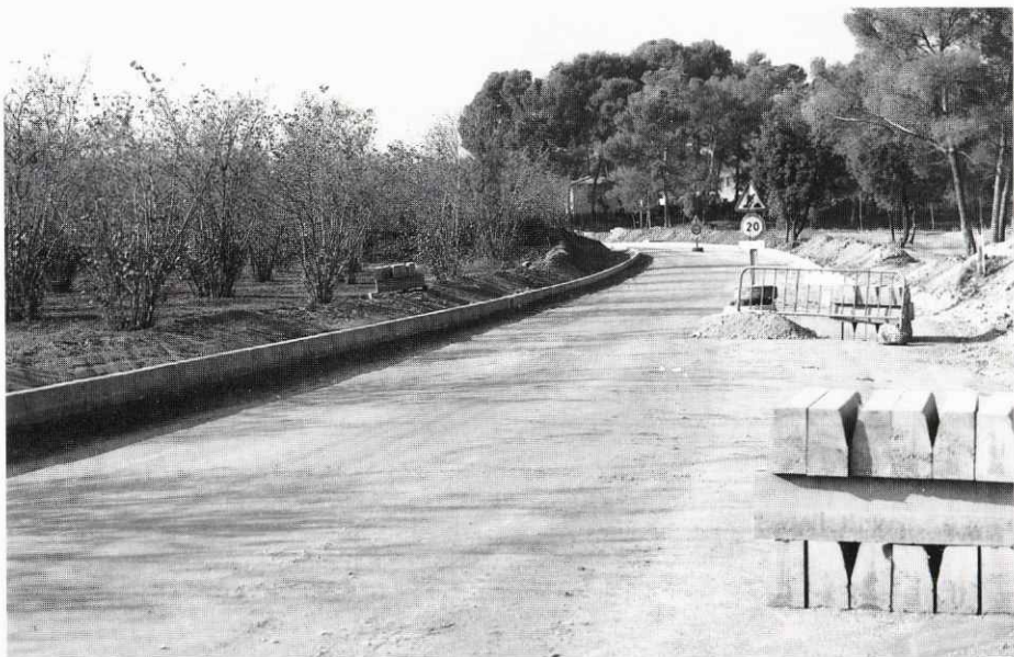
Obres de pavimentació del Camí de la Serra davant l'ermita de Sant Simple.
