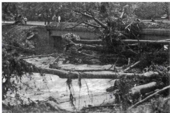
Els efectes de la riuada al pont de Sant Cristòfol.
