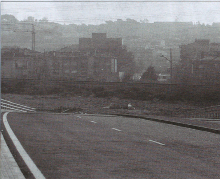
El tramo que va desde la plaza Francesc Macià en Can Calet hasta la rotonda del polígono industrial Congost, será el que esté conectado mediante las vías soterradas.
