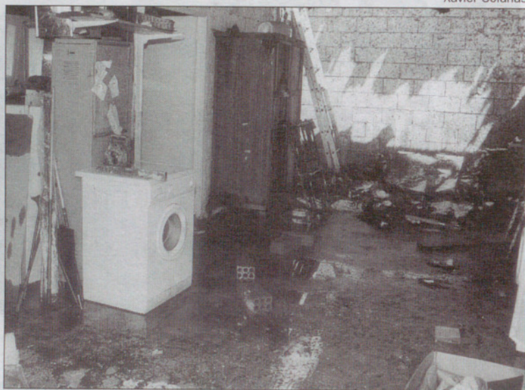
Estado en que quedó el almacén del geriátrico tras el incendio del martes.
