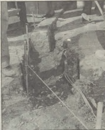
Els fils eren directament enterrats, sense cap protecció.
