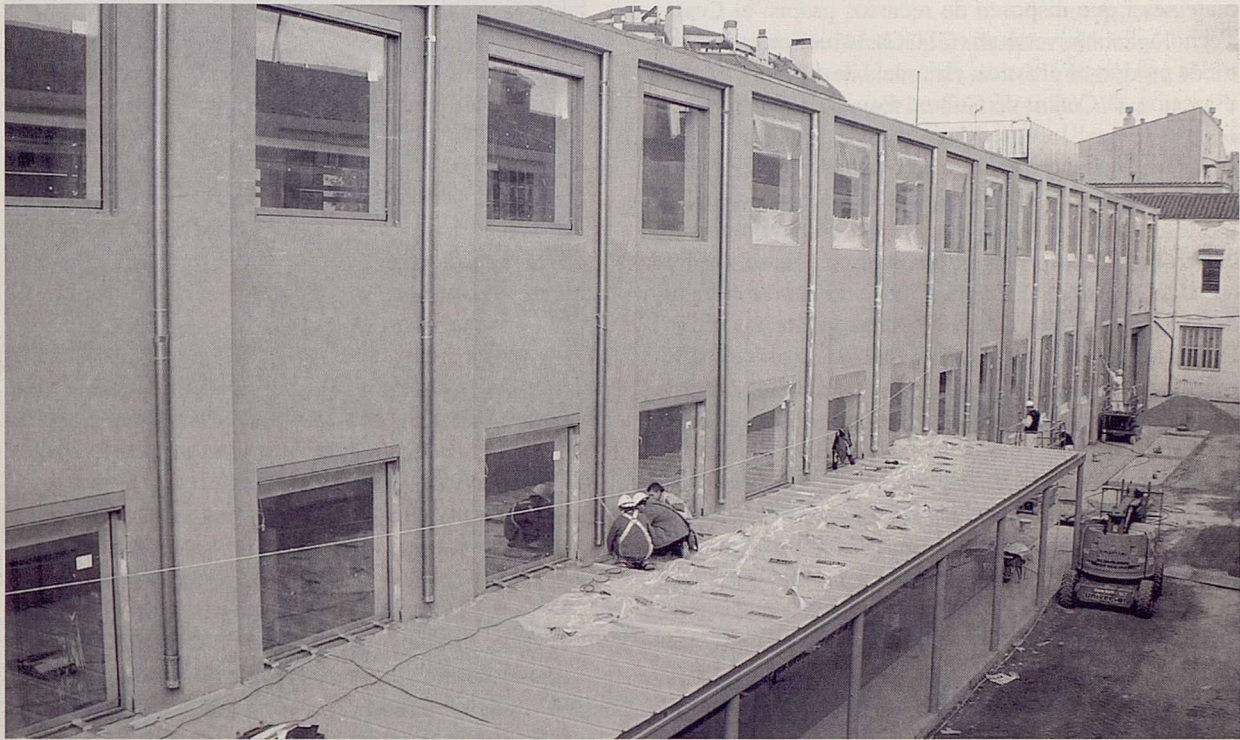
Obres d'adequació d'una de les naus de l'antiga factoria. (Foto: Gabinet de Comunicació)
