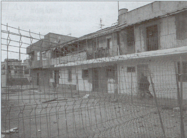
Un solar privado en la calle Sol presenta un alto grado de dejadez y edificios muy precarios.
