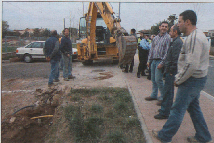
Los técnicos de la compañía del gas repararon la avería que no afectó a más clientes que los de la propia vivienda.
