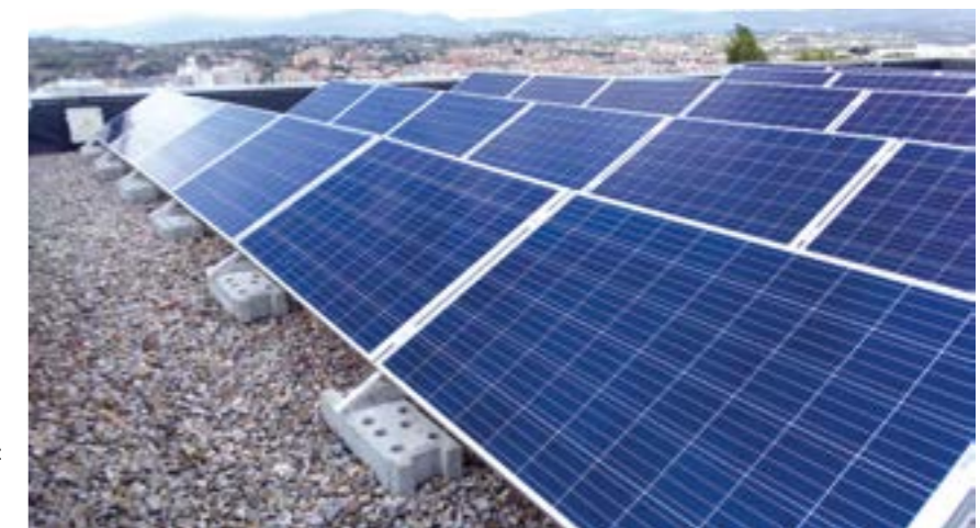
Plaques solars fotovoltaïques al Centre Vallès
