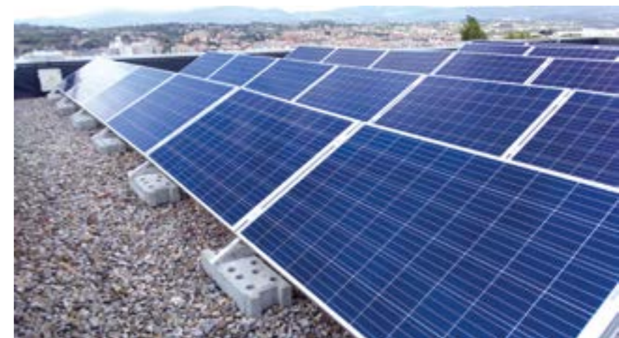
Plaques solars fotovoltaïques al Centre Vallès
