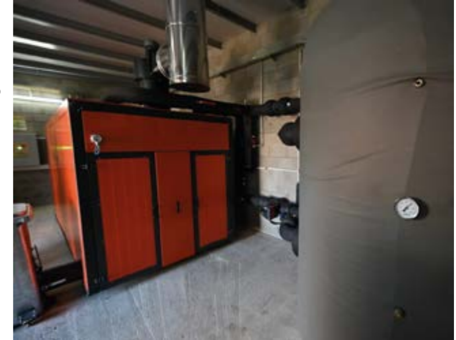
Caldera i acumulador de la Xarxa Nord
