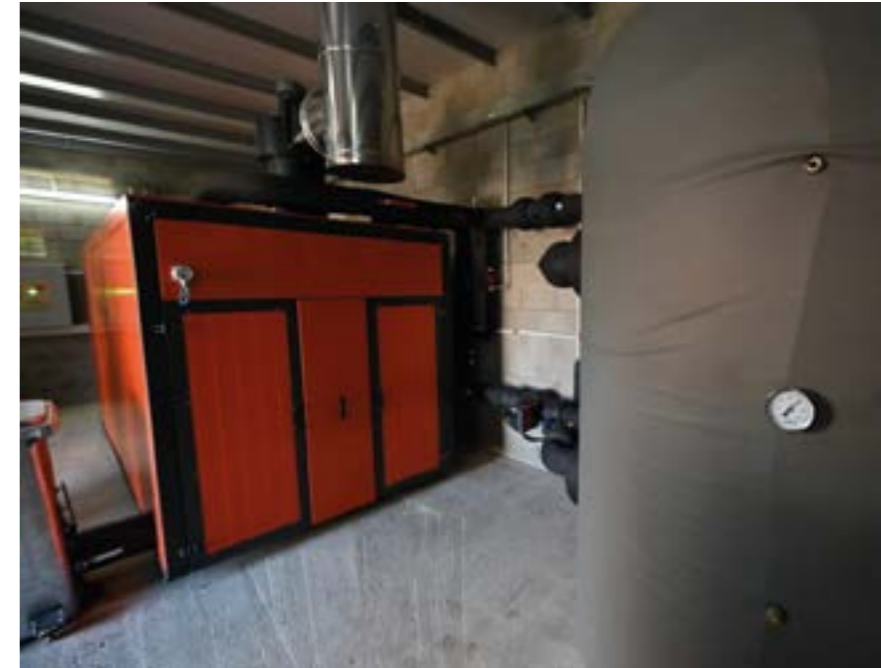
Caldera i acumulador de la Xarxa Nord
