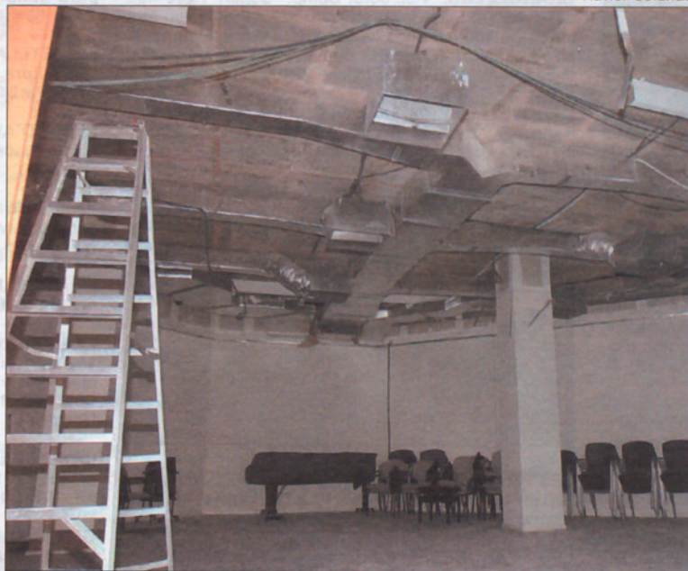
Estado en que quedó la sala de actos después del desplome del techo.
