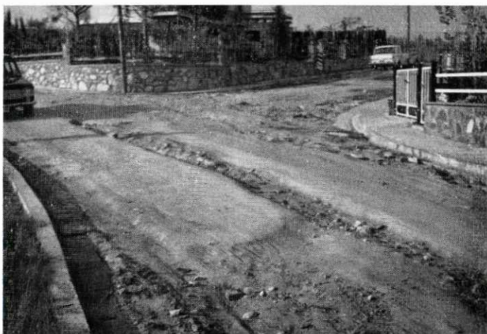
Vista parcial de una calle antes de las mejoras
