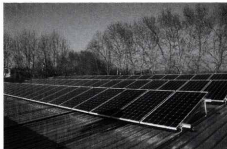
Les noves plaques solars de La Fàbrica.
