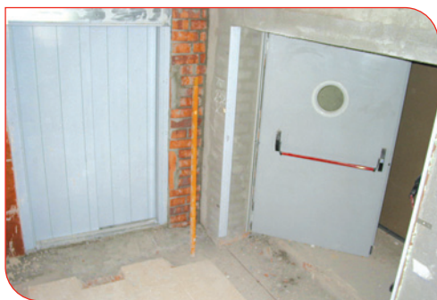
Ascensor i porta per comunicar les plantes de l'edifici B
