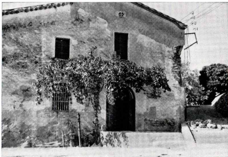
Desperfectos ocasionados en el edificio de «Can Colom» por el choque a que se hace referencia.
