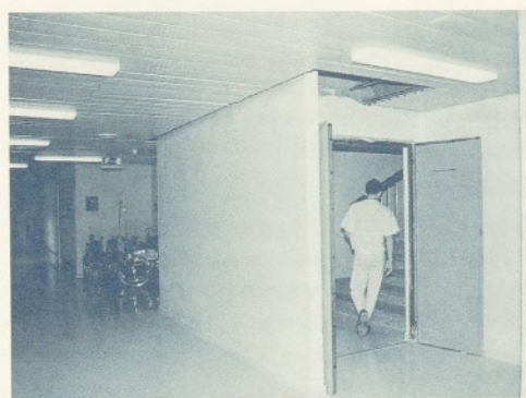
En cas d'incendi, les escales han de funcionar de tallafocs.
