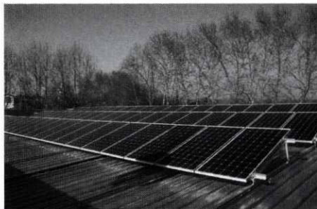
Les noves plaques solars de La Fàbrica.
