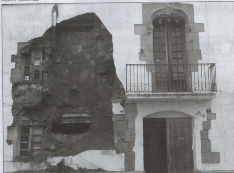
El boquete abierto en la fachada el martes.
